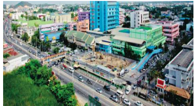
รูปขณะก่อสร้างอาคารอุบัติเหตุและศัลยกรรมกระดูก “อาคาร ชลายุวัฒน์”
