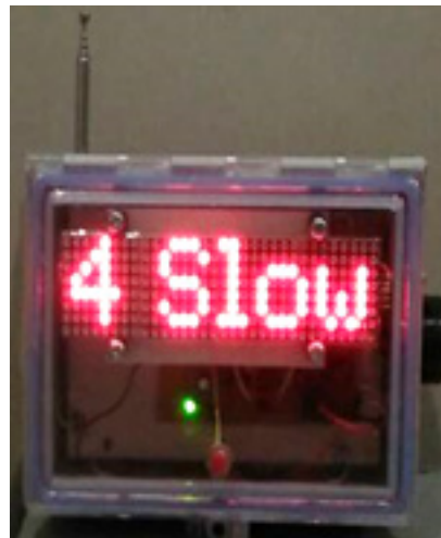
ภาพที่ 3 จอแสดงอักษรวิ่งเตือนที่เครื่องติดตามการทำงานระยะไกลแบบไร้สาย
