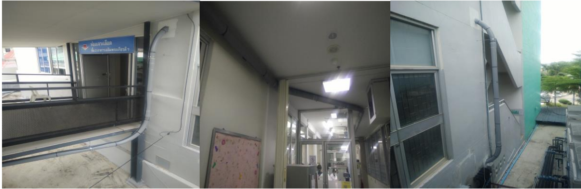
รูปที่ 6 ท่อส่งนอกและในอาคาร
